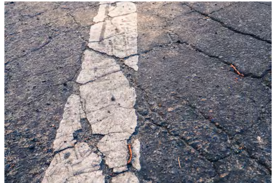
▲ Droogte kan zorgen voor schade aan wegen.
